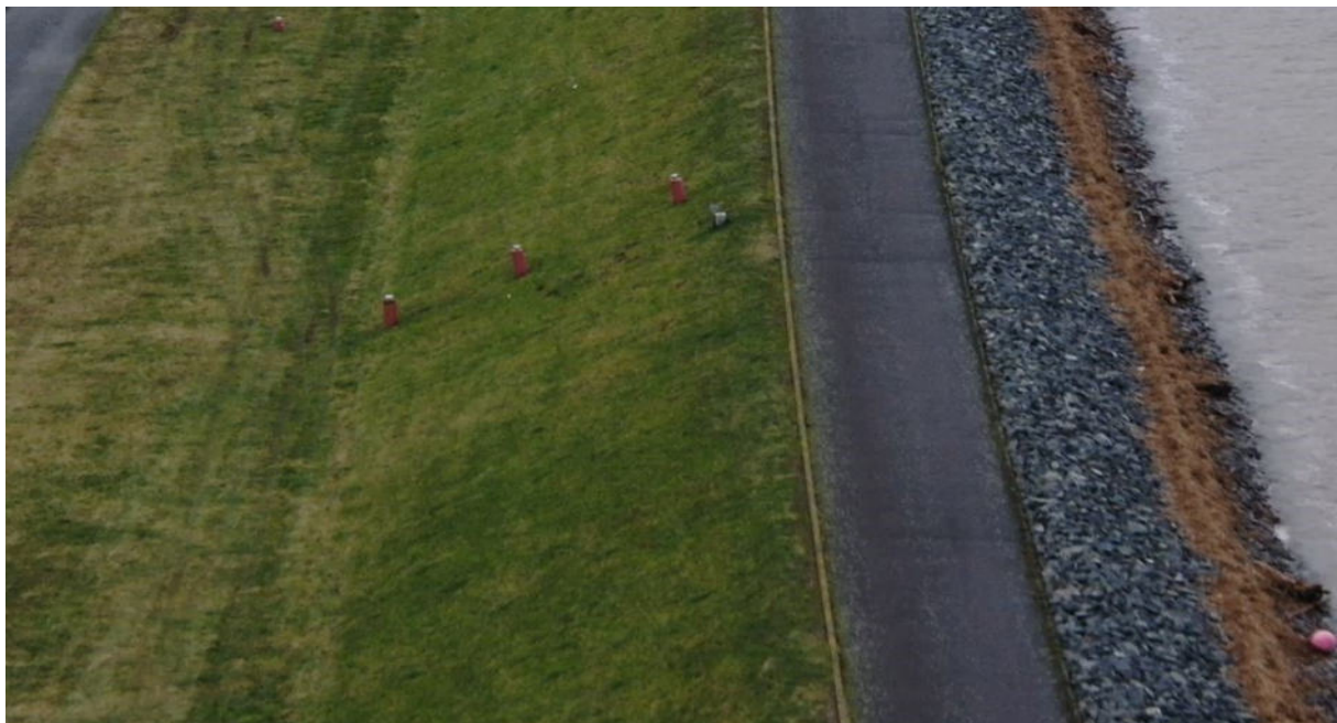
Abbildung 40 TS Kelbra, Beispiel für Messungen einer Sickerlinie
