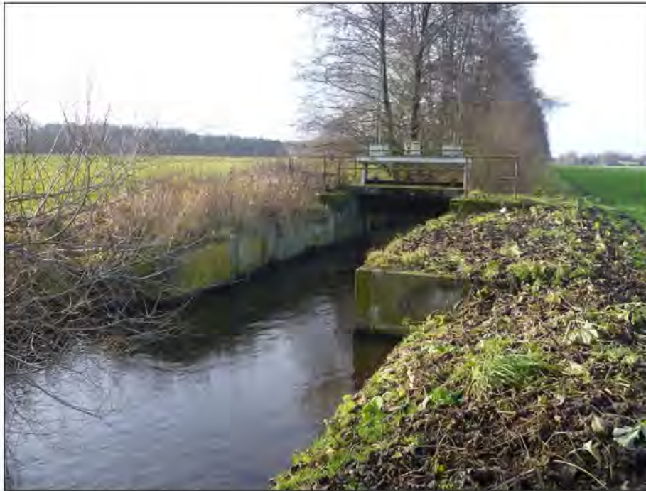
Abb. 4: Stauanlage km 13+914, Salzwedeler Dumme (08.12.2011)
