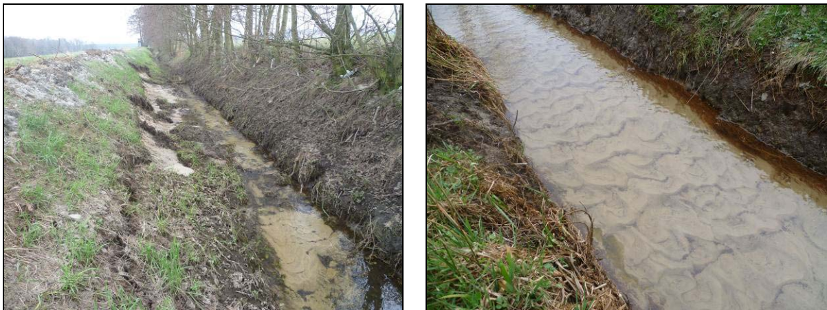
Abbildung 54: Feinsandeintrag in die Boner Nuthe aus nicht standsicheren Böschungen (links) und Feinsandablagerungen in der Gewässersohle unterhalb der Eintragsflächen (rechts), (Fotos: Wernike)
